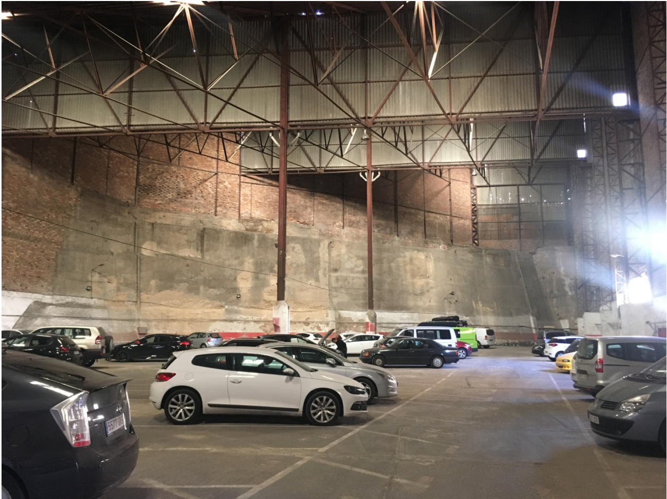
Interior de las Naves Melero, con l actual uso de aparcamiento pero desaprovechando el potencial de la volumetría.
